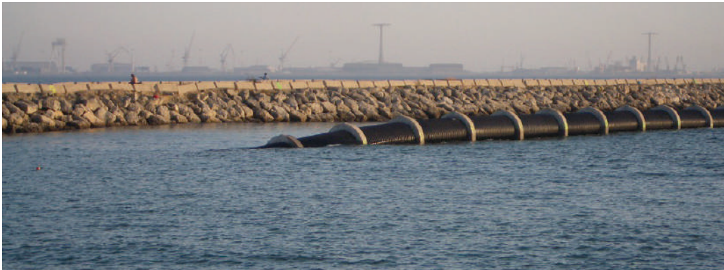
Instalación de 800 ml de emisario submarino de polietileno alta densidad (PEAD) de 2.000 mm de diámetro en la Bahía de Cádiz.
