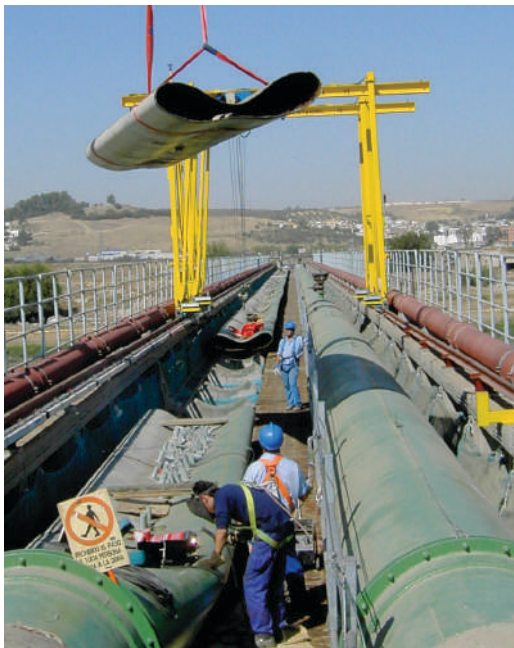
Una tubería de 1.300 mm de diámetro colapsada por una fuerte depresión en su interior, debido al fallo en una ventosa.
